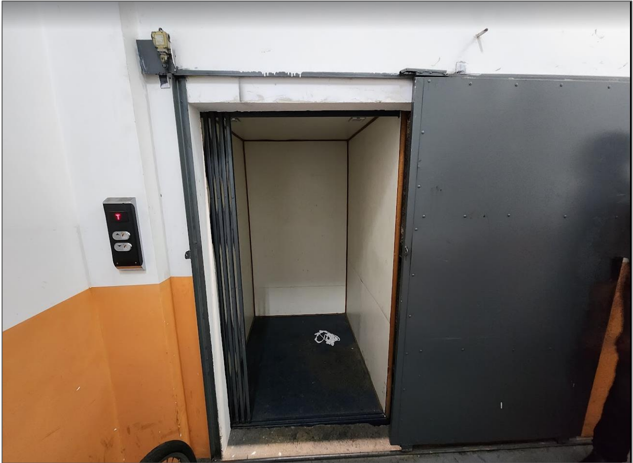
Foto 05: Elevador (1º pavimento)
